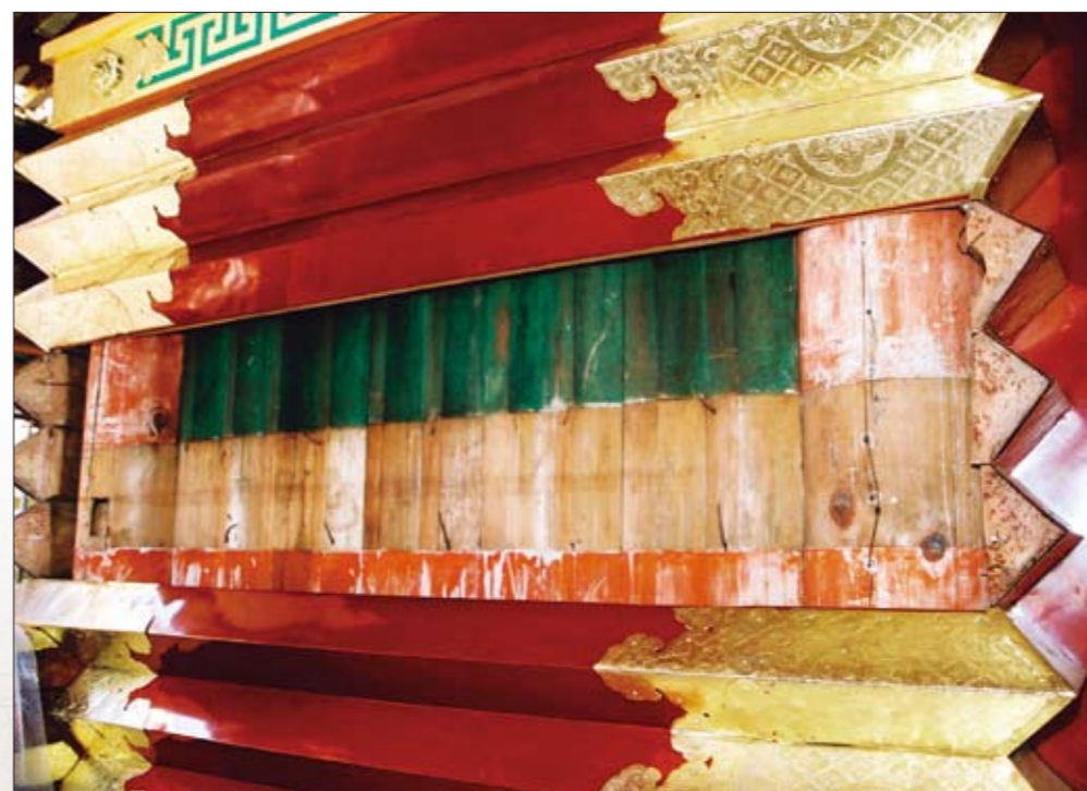
東照宮中神庫 秀忠公が東照社を創建した当時の建物であることが現校木(あぜき)裏側に残っている柱間の構えや塗装から分かります。それらは修理工事中の調査で明らかになりました。
