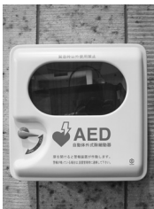
市役所本庁舎2階にあるAED
