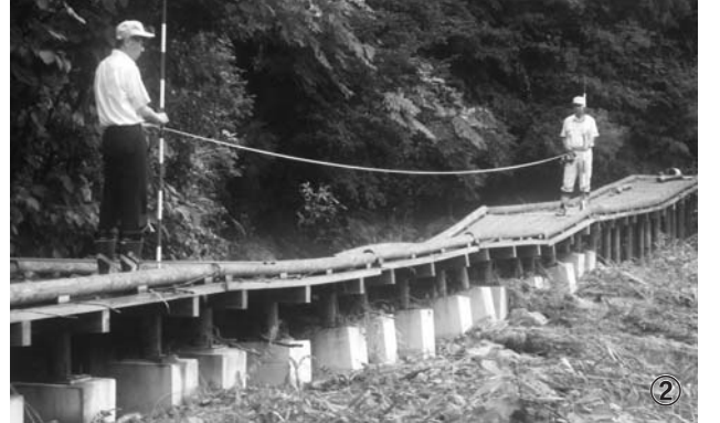
①増水した湯西川の影響により、道路が崩壊した県道黒部西川線。②鬼怒川の増水により、被害を受けた大滝遊歩道(藤原地域)。
