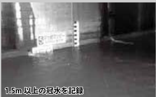
大雨で冠水した平ヶ崎アンダー
