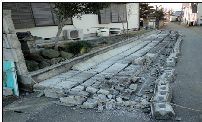
ブロック塀の倒壊
