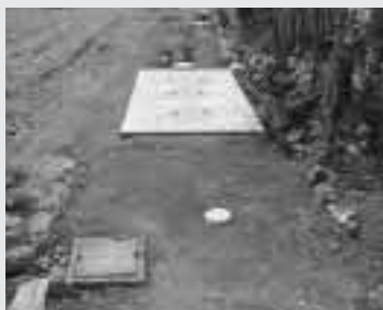
浄化槽設置整備事業 合併浄化槽の普及促進 のための助成を行います。
