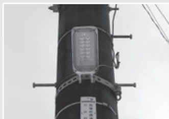
防犯灯整備事業費 電柱に設置されたLED防犯灯です。
