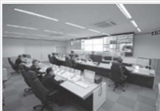
消防本部運営費 運用を開始した高機能消防指令センターです。
