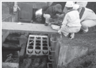
再生可能エネルギー推進事業費 学産官連携により小水力発電を設置している様子です。
