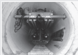
公共下水道建設事業費 平成町地内（今市地域）に 設置したマンホールポンプ 内部の様子です。
