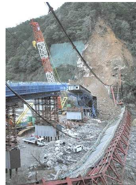
2015.1.31 浜松市原田橋 崩落 2名死亡
