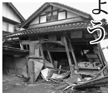
地震により半壊した家屋。
