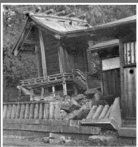
傾いた瀧尾神社の本殿と崩れた石垣。
