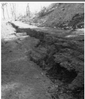
大きな亀裂が入った道路。
