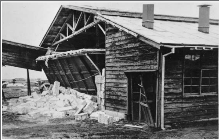
無残に崩れた石垣と建物の外壁。
