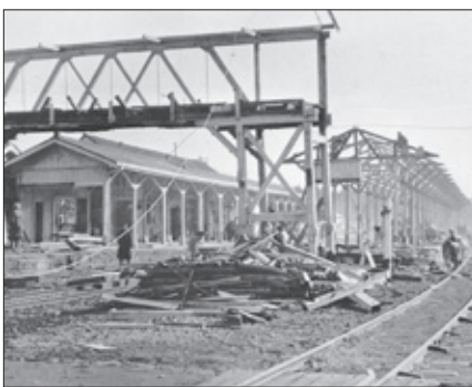
崩落した今市駅の設備
