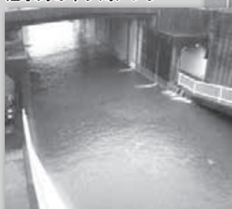
冠水時の平ヶ崎アンダー
