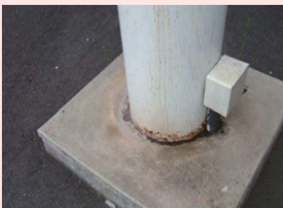
ポールの根元にサビが発生
