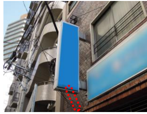
振れ止め棒が変形した状態
