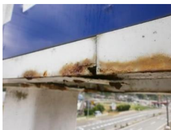
その他（塗装剥離、腐食など）
