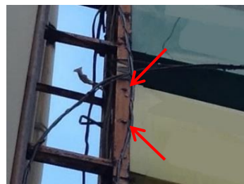
ボルトのゆるみや欠落した状態
