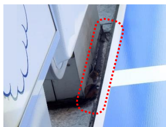
コーキングが劣化した状態
