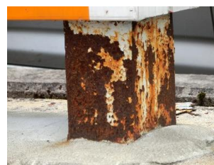
支柱根元の腐食が進行した状態
