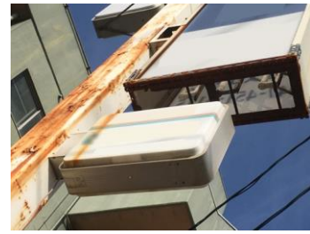
支柱にさびが発生した状態
