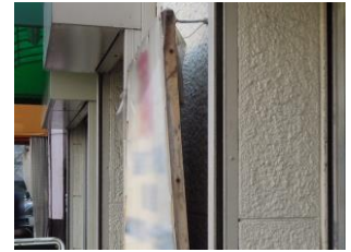
壁面との間に隙間が生じた状態
