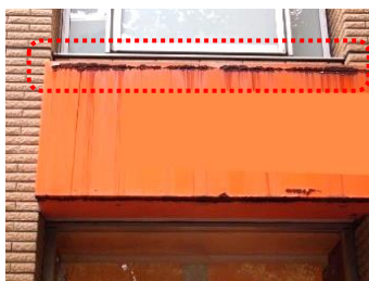
その他（塗装剥離、腐食など）
