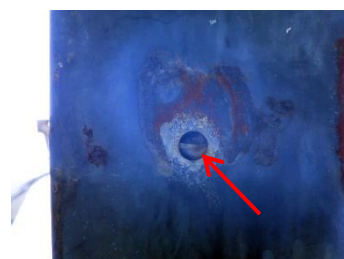
水抜き孔の詰まり
