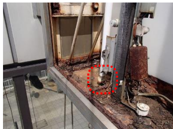
蛍光灯のホルダーが破損した状態
