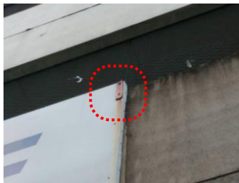
金具が劣化した状態
