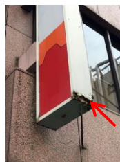
広告板底部の腐食が進行した状態
