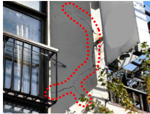
壁面にひびが生じた状態
