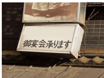
屋外広告物本体の傾き
