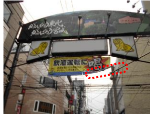
幕材を張る部材が破損した 状態
