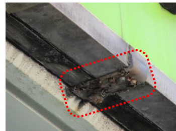
金具が劣化した状態
