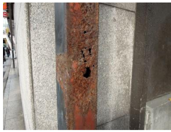
支柱の腐食が進行した状態
