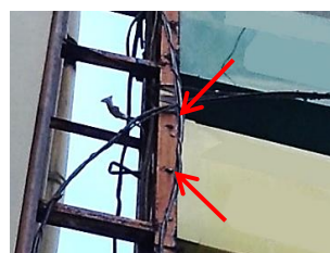
ボルトのゆるみや欠落した状態
