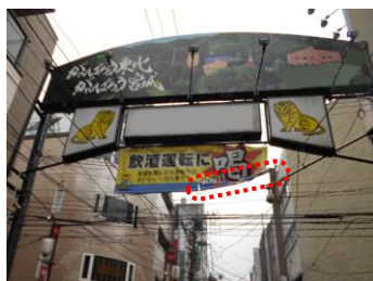
幕材を張る部材が破損した状態
