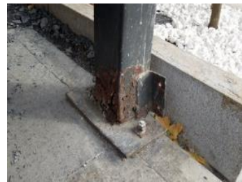
支柱根元の腐食が進行した状態
