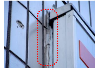
コーキングが劣化した状態
