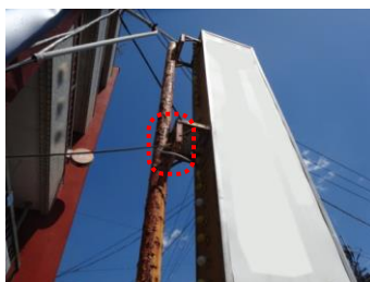
支柱・広告板接合部の腐食・隙間
