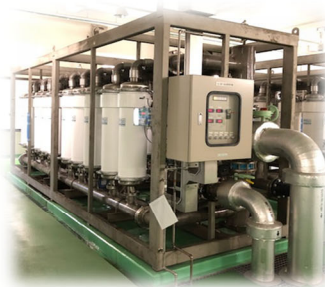
瀬尾浄水場 膜ろ過設備
