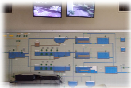
鬼怒川浄水場 中央監視設備
