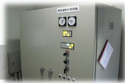
瀬尾浄水場 緊急遮断弁 制御盤
