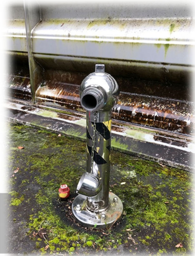
小倉山配水池 災害用給水栓 拡大図
