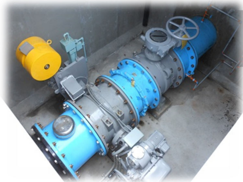
瀬尾浄水場 第3配水池 緊急遮断弁
