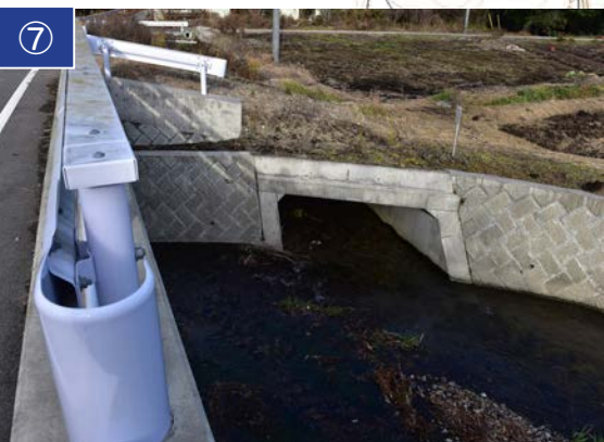
↑田川放水口（千本木地内）
