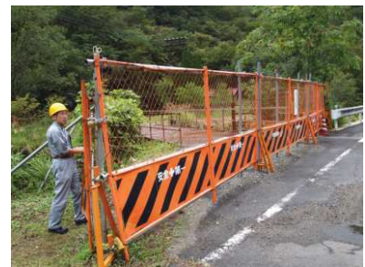
出川にかかる橋梁の閉鎖状況
