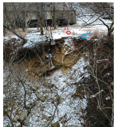
出川の石積護岸崩落状況
