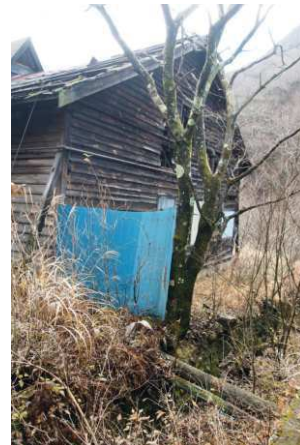
水路石積上に生育する樹木
