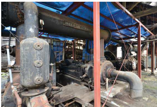
建屋内の大型コンプレッサー2基
