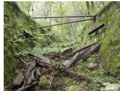
水路及び崩落した木橋
