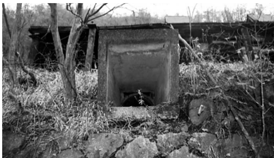
写真－ 35 動力所と繋がる排水用設備
