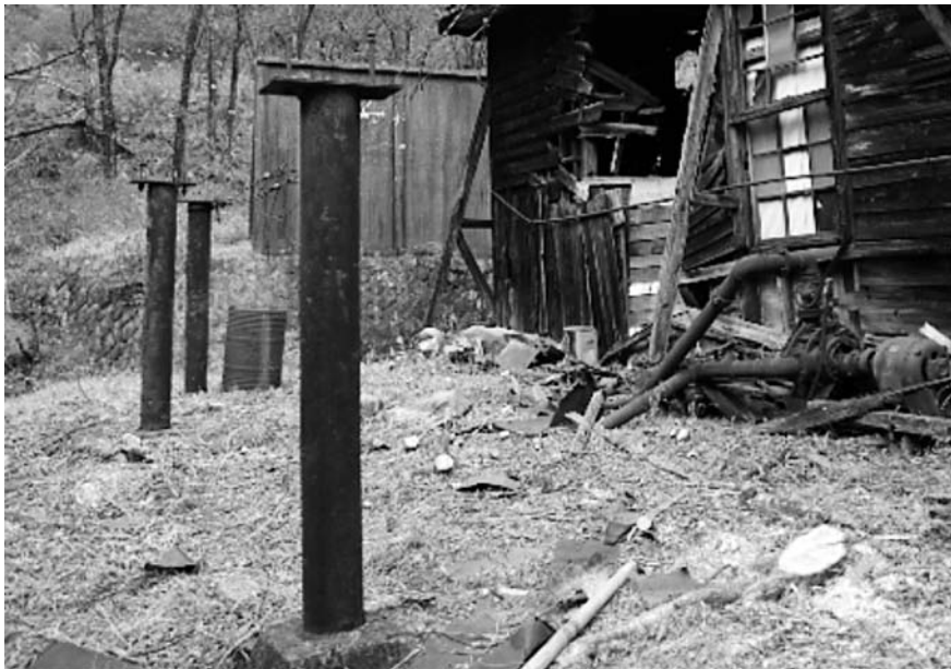
写真－31 鉄管を支えた支柱
