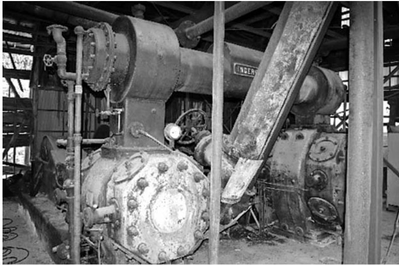
写真－22 8号機 (PRE- 2) 気筒とインタークーラー
