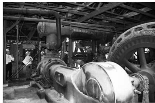
写真-2 本山動力所内部と圧気機(4号機)
