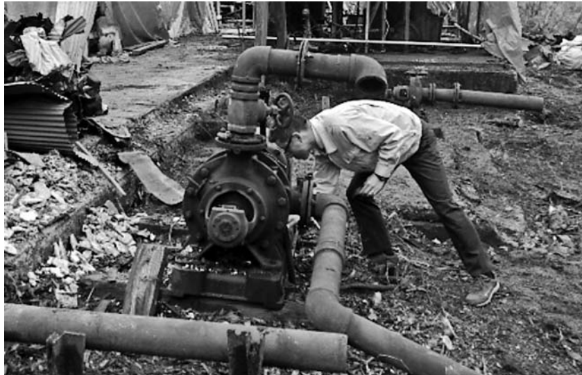
写真－ 32 給水用ポンプ
