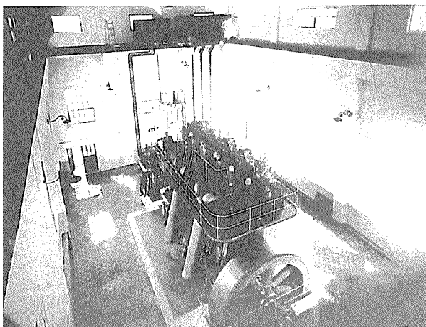
新梨子油力発電所 (古河機械金属㈱提供)
