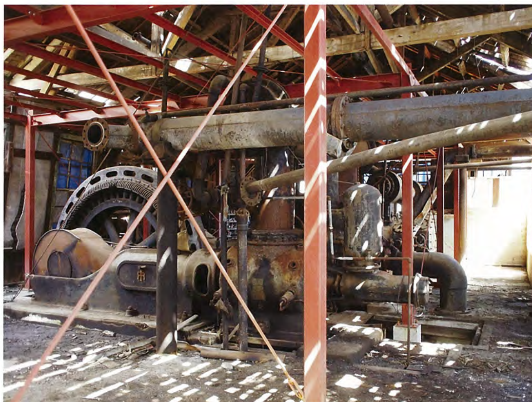
【採鉱施設】本山動力所内コンプレッサー
