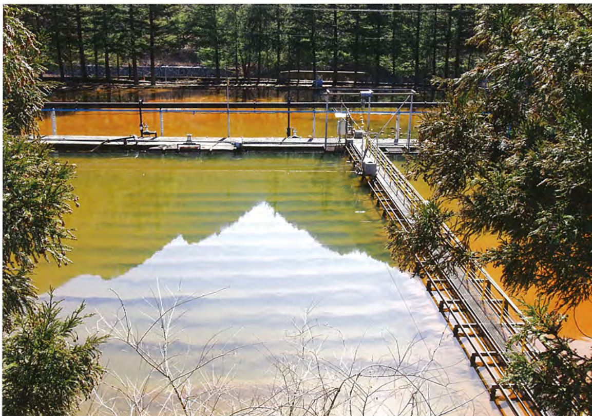
【浄水施設】中才浄水場
