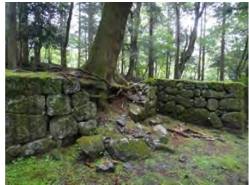
図2-7：植物の根による石垣の損傷 (養源院跡)
