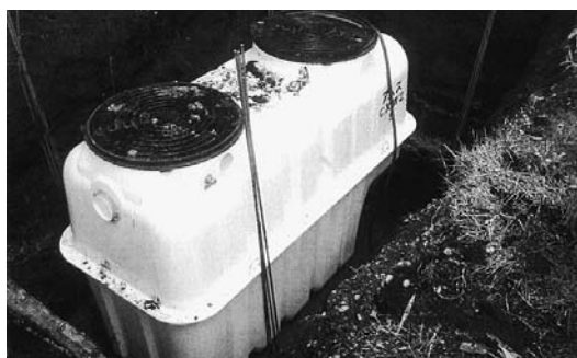
合併浄化槽を設置して衛生的に 安全な水を放流します
