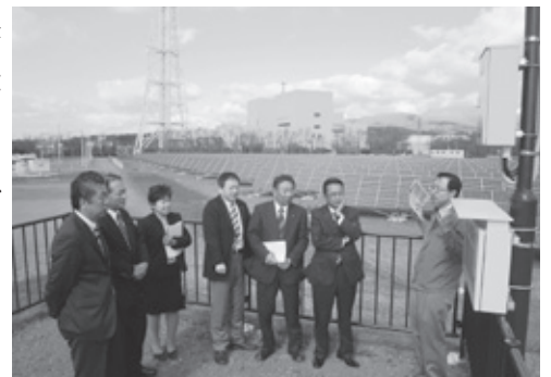
メガソーラー発電（北海道電力伊達発電所）
