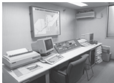
防災行政無線室（足尾総合支所）
