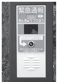
大沢地区の緊急通報装置
