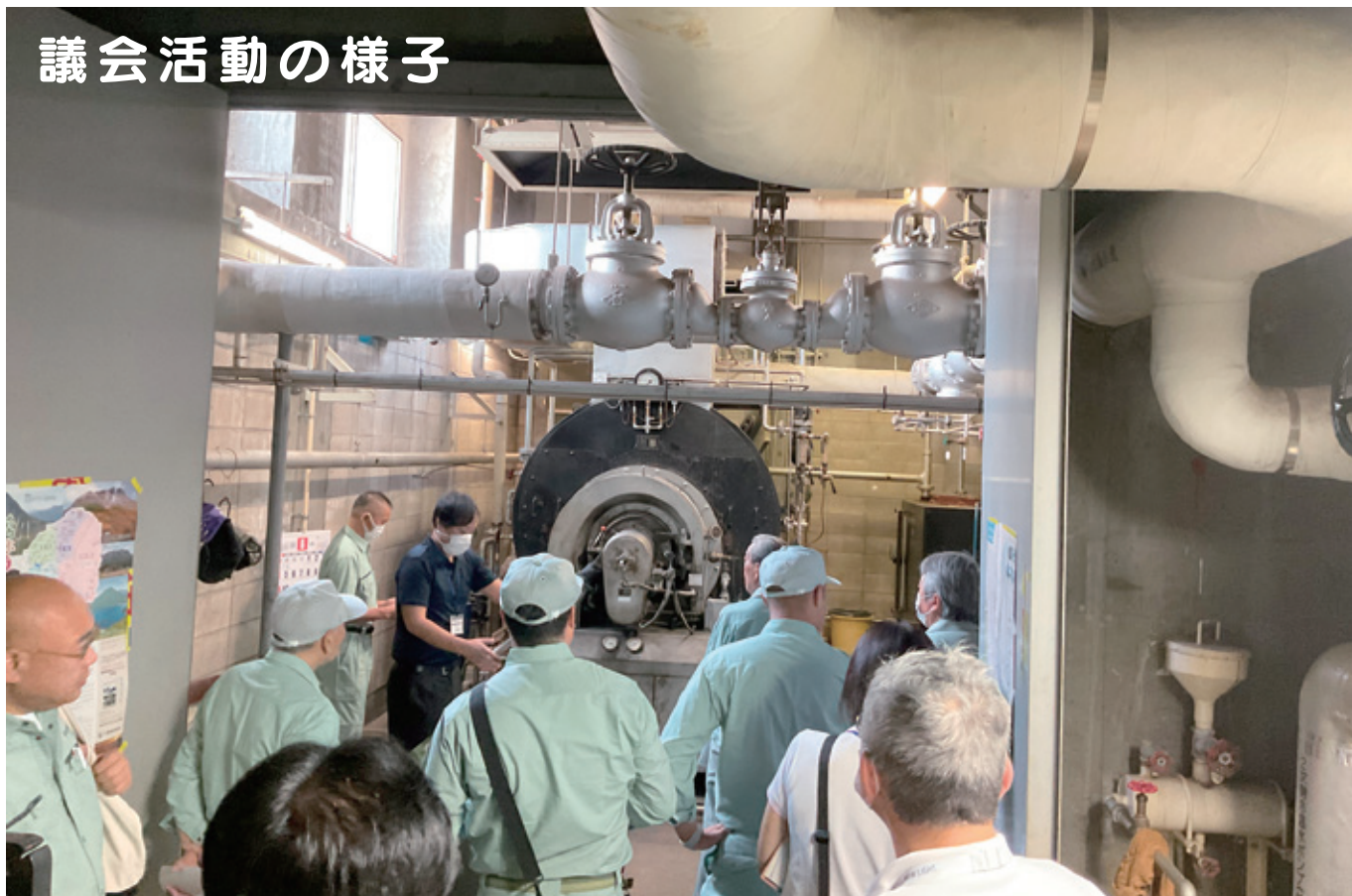
公共施設等あり方検討調査特別委員会による今市文化会館の劣化状況等の現地調査
