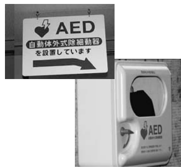
本庁舎内に設置してあります。
