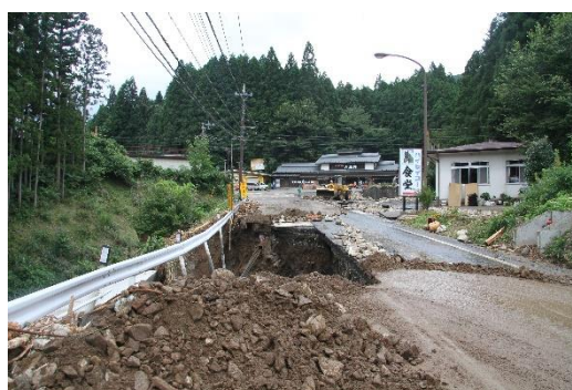
土砂が流れ込み陥没した国道 121 号線
