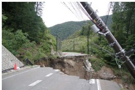
崩落した県道黒部西川線
