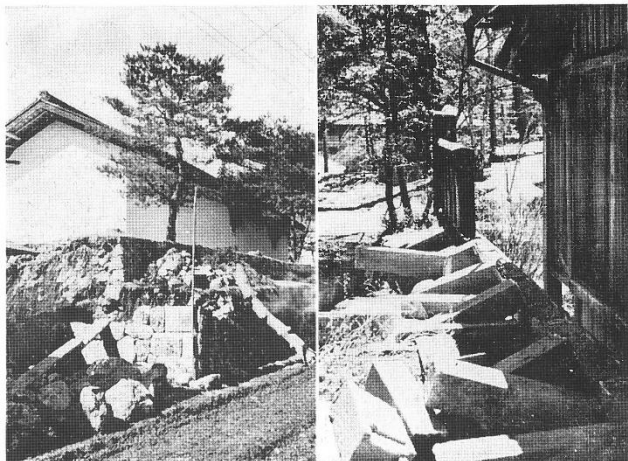
日光輪王寺倉庫脇も崩れる
