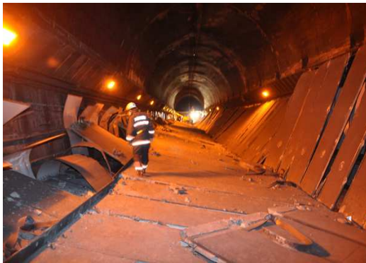
笹子トンネルの事故状況: 山梨県大月市消防本部提供資料
